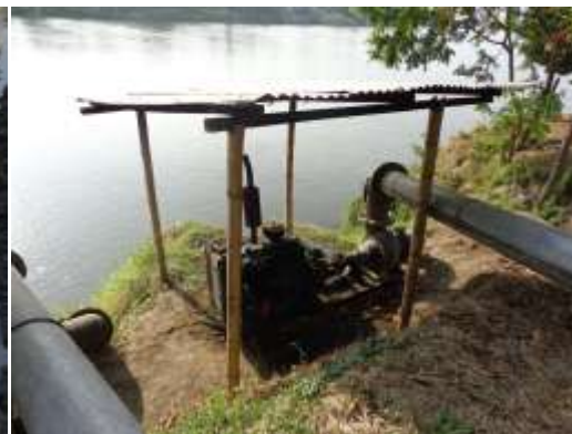
Foto de la bomba de riego del río Daule
