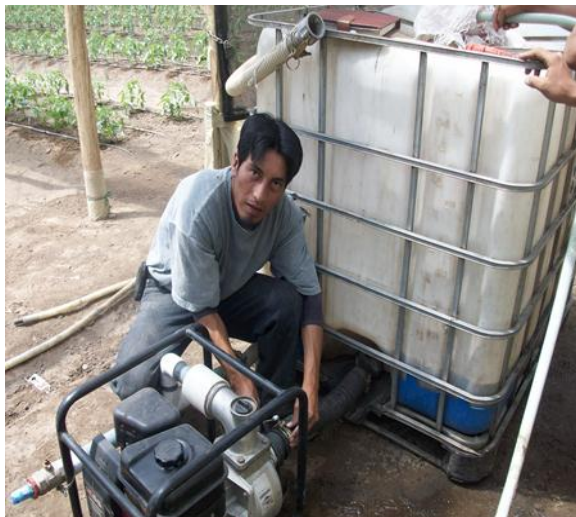
Calibración de bomba mecánica
